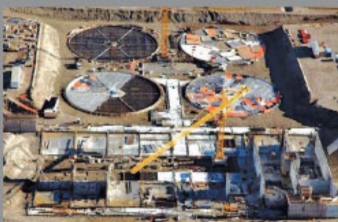
Canadá, PTAR Pine Creek
