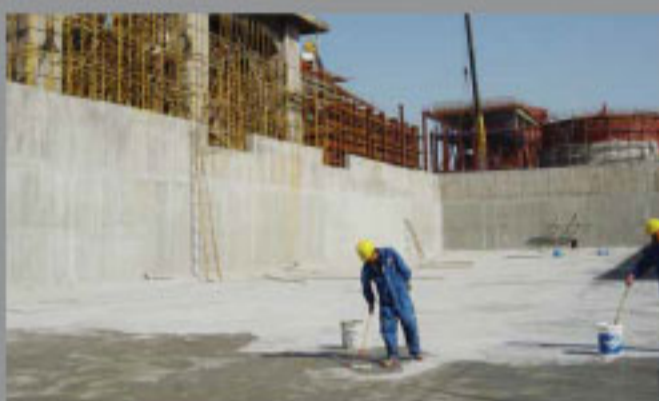
Almacenaje de Carbón en Planta Termoeléctrica, China
